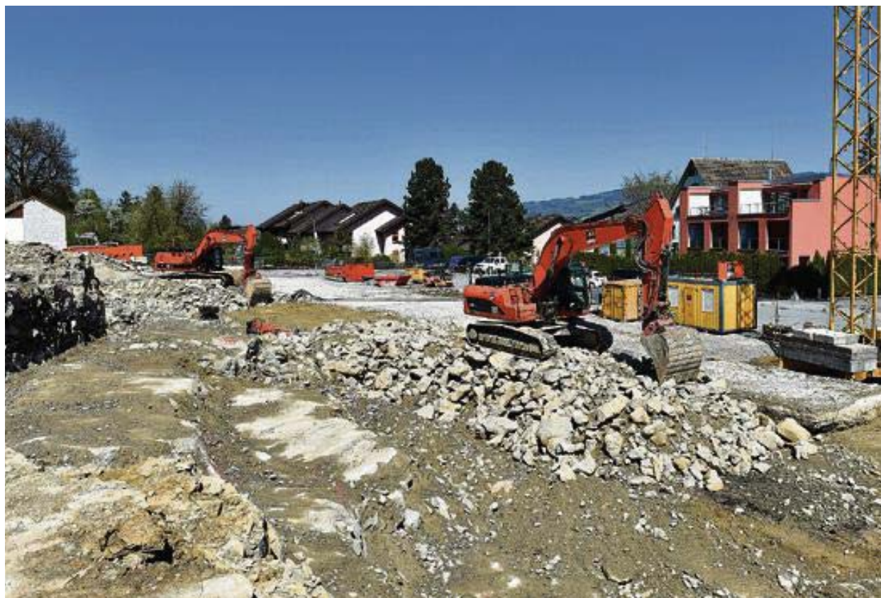
Mit der Grossüberbauung Four Sisters der MBG an der Neudorfstrasse und am Fluhweg geht es nun zügig voran.
