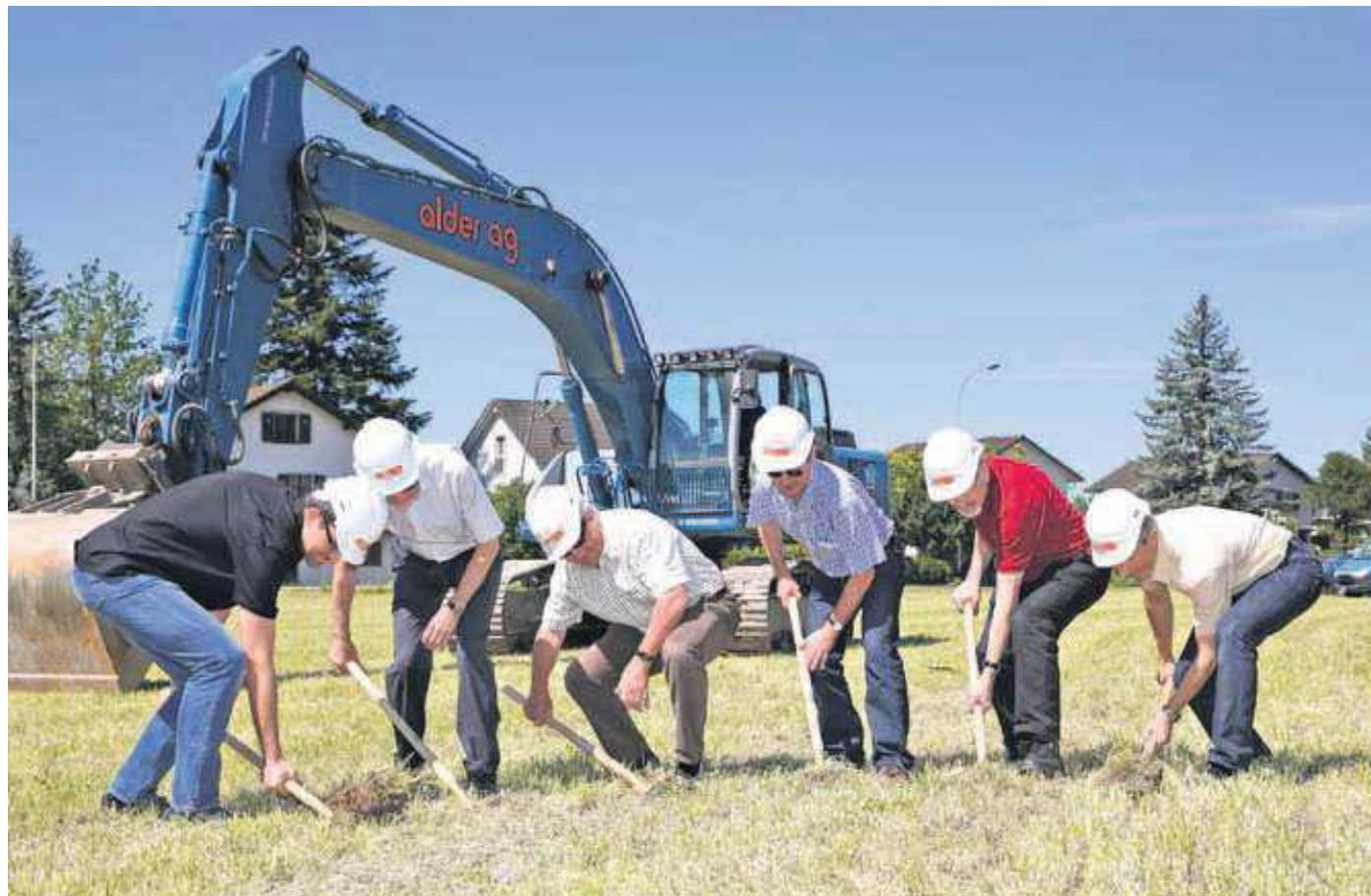
Eitel Sonnenschein beim Spatenstich: Während der Bagger schon aufgefahren war, machten sich Vertreter der Bauherrschaften und der Politik von Hand ans Werk. Bild: hag
