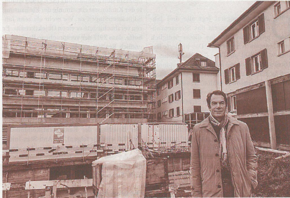
Freut sich auf der Plattenhof-Baustelle über das geplante Wohnheim: Horizonte-Geschäftsführer Erwin Wachter. Arthur Schächli
