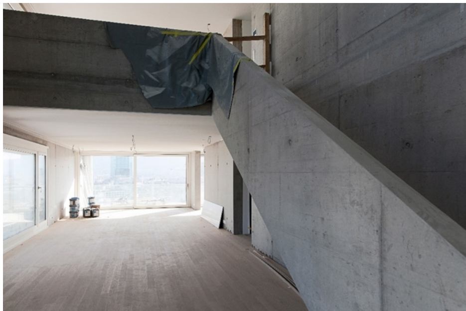
Viel Wohnraum beanspruchen vor allem Singles: Wohnung der Escher-Terrassen im Rohbau (2014). Bild: Dieter Seeger
